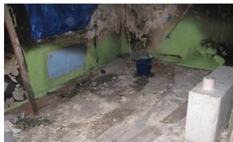
Zdjęcie po pożarze jednego z pomieszczeń
